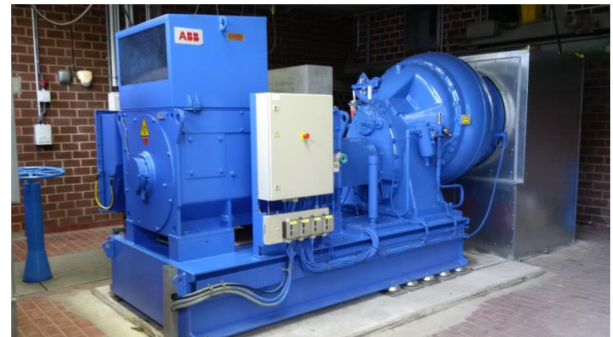
Turboverdichter KA Buchenhofen (Wupperverband)
