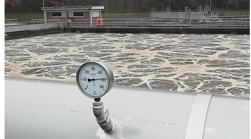
Luftleitung und belüftetes Becken, KA Buchenhofen (Wupperverband)
